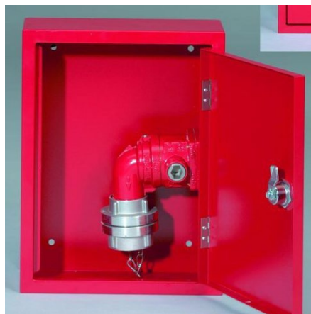
Figur 9.4 viser brandskab til aflåsning af stigrør med drejelig albue således ventil kan svinge ud og tilkobling af slanger kan ske uden knæk.
