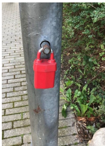
Figur 5.1 viser eksempel på spærring i brandvej aflåst med hængelås som kan låses op med CyberKey.
